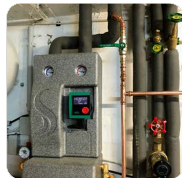
Hocheffizienzpumpe mit Dämmung
